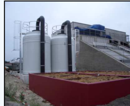
Geruchs- und Biofilter
