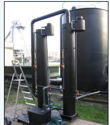
Neue Entwicklung, biologische Luftreinigung
